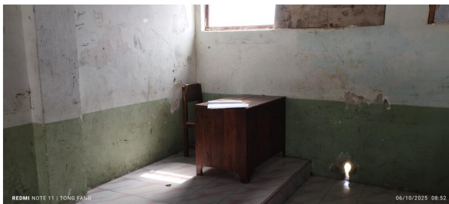
Gambar 5. 3 Foto Kelas Ruangan Yang Membutuhkan Perawatan
